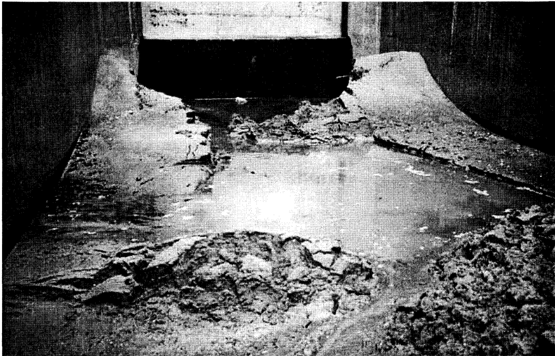
H7 Sediment in the AWS Conduit
